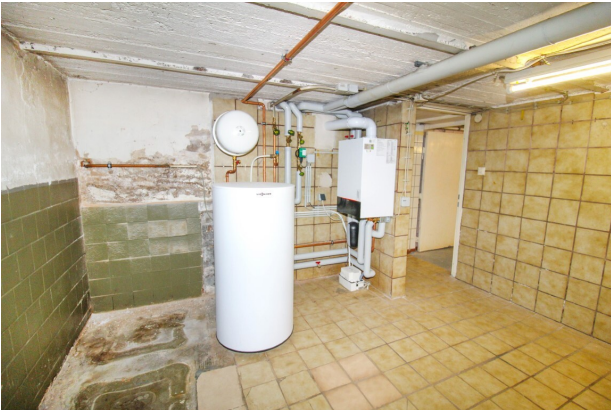
KG Keller 2 Heizung Bild 4 ()
