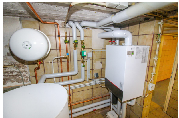
KG Keller 2 Heizung Bild 5 ()
