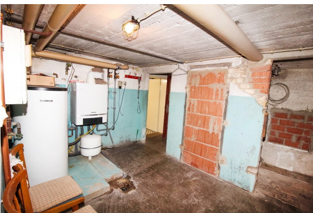
KG Heizung Bild 1
